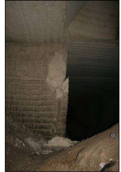
Rotture agli spigoli dei pilastri
